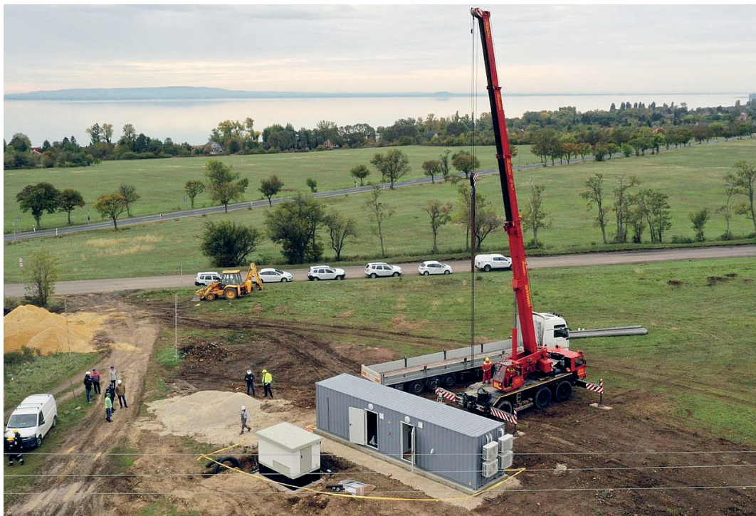
Energiatároló telepítése Zánkán (eon.hu)
